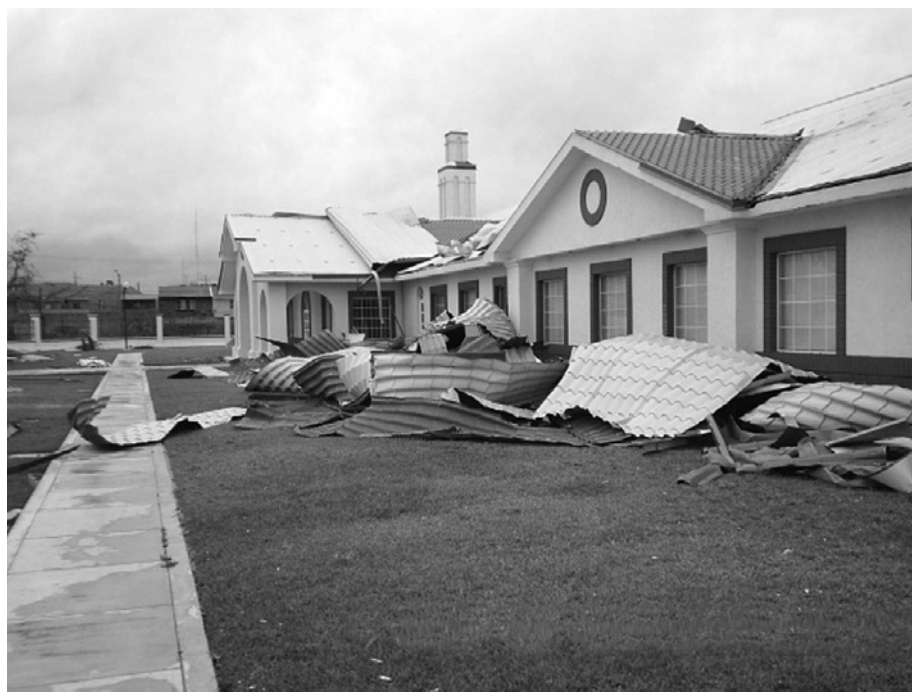
Orkanen Wilma orsakade omfattande skador på det här möteshuset i Cancún i Mexico.
