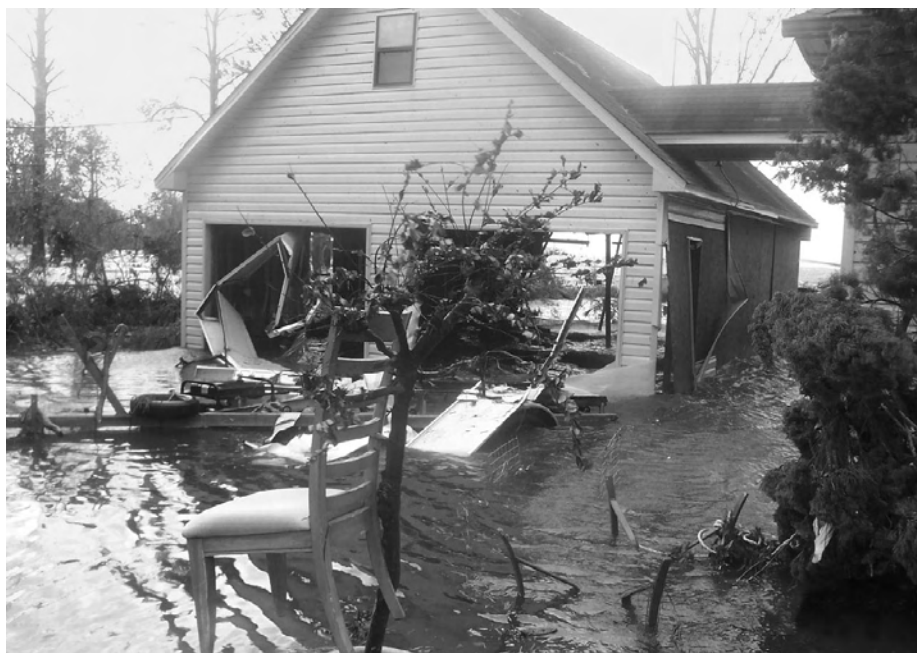
Vind och vågor från orkanerna förstörde många byggnader, bland annat en del av detta hus i Florida.
